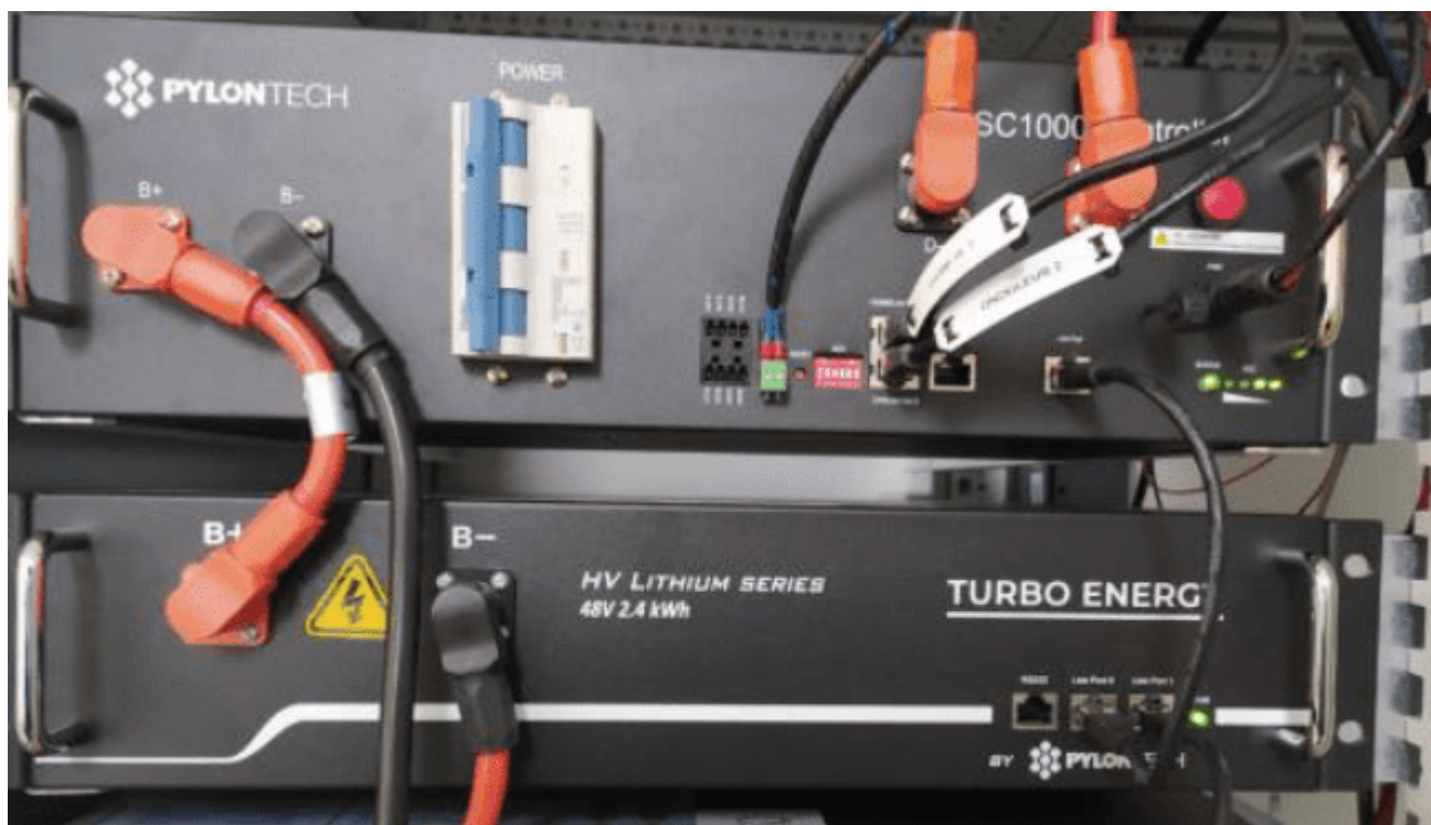
Batterie Pylontech (étape 5)
