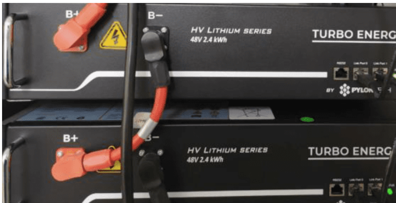
Batterie Pylontech (étape 2)
